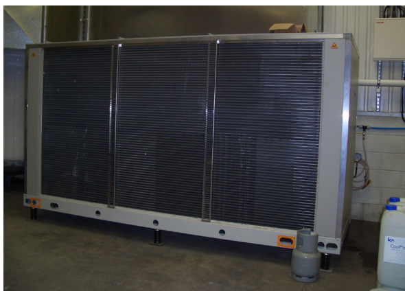
The 2000kW HRAT Unit
