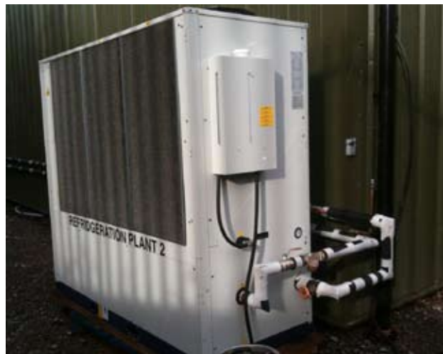
71kW TAEvo 351 chiller
